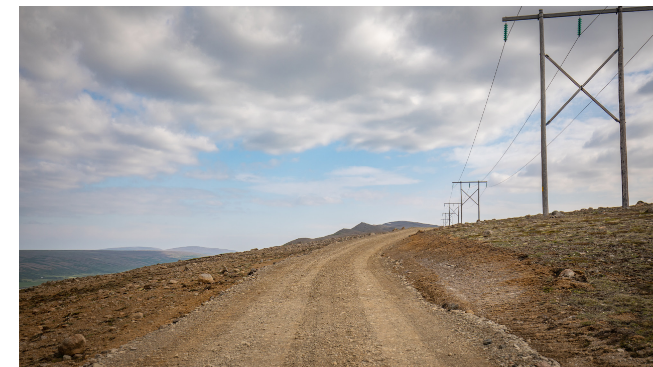
Dæmi 4. Nýleg línuslóð vegna Hólasandslínu 3
